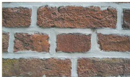
1- La brique de cette maçonnerie a été endommagée : son épiderme est grêlée. Un nettoyage inadapté en est la cause, sans doute un sablage trop agressif.
