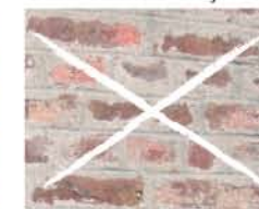
Le rejointoiement au ciment néfaste à la maçonnerie
