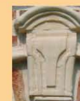
4- Ici, les détails sculptés de cette clef de fenêtre ont été plus ou moins effacés suite à un nettoyage trop abrasif.
