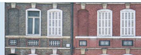
Le badigeon de chaux doit s'appliquer dans le respect des matériaux de façade.
