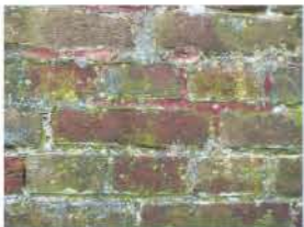
Assainir la maçonnerie envahie par les micro-organismes verts,
