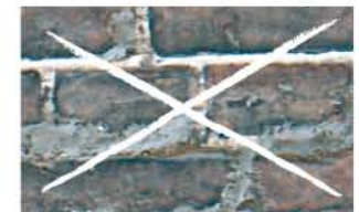
Altération du support par remplacement partiel d'un joint saillant par un mortier de ciment.
