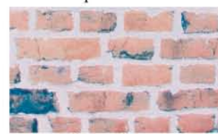
Appareillage endommagé suite à un déjointoiement brutal : brique cassée, joint élargi
