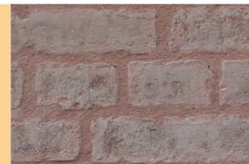
2- Ci-dessus, l'épiderme de la brique a été préservée. la brique a été débarrassée du voile gris de la pollution tout en conservant ses qualités esthétiques et techniques.
