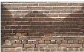
Combattre les infiltrations d'eau dans la maçonnerie en restaurant le joint disparu.
